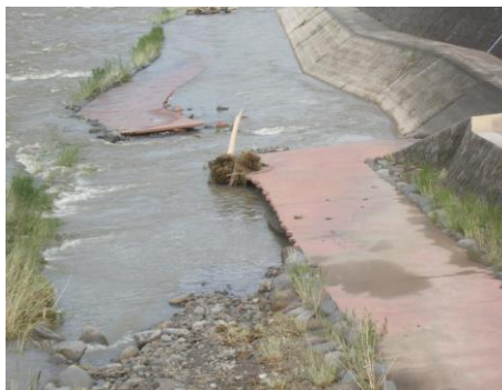
壊された散歩道路(御幸橋下流)
