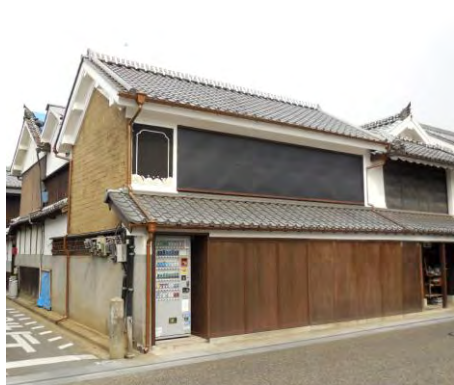
一期目工事が終了した水田家の店舗東棟。二期目は奥の西棟が工事予定
