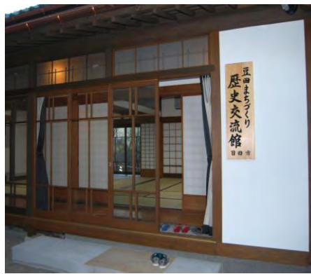
切り石で造られた上がり台を設置し、新たに作られた玄関。
