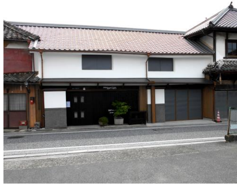
いぶし瓦への葺き替えや壁の漆喰塗り の補修工事が完了した長尾家と田中家
