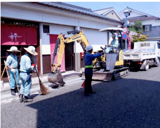
石畳みの撤去工事を皮切りに 始まった市道御幸通り線の舗装工事
