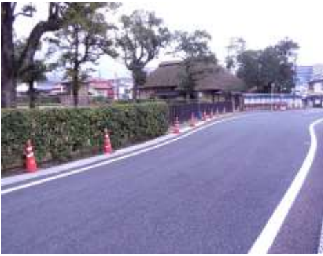
市道御幸通り線で残された部分の舗装工事が12月末に完了しました。写真は咸宜園前
